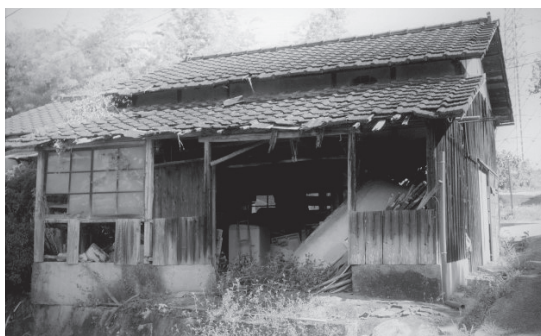
▲放置された空き家
